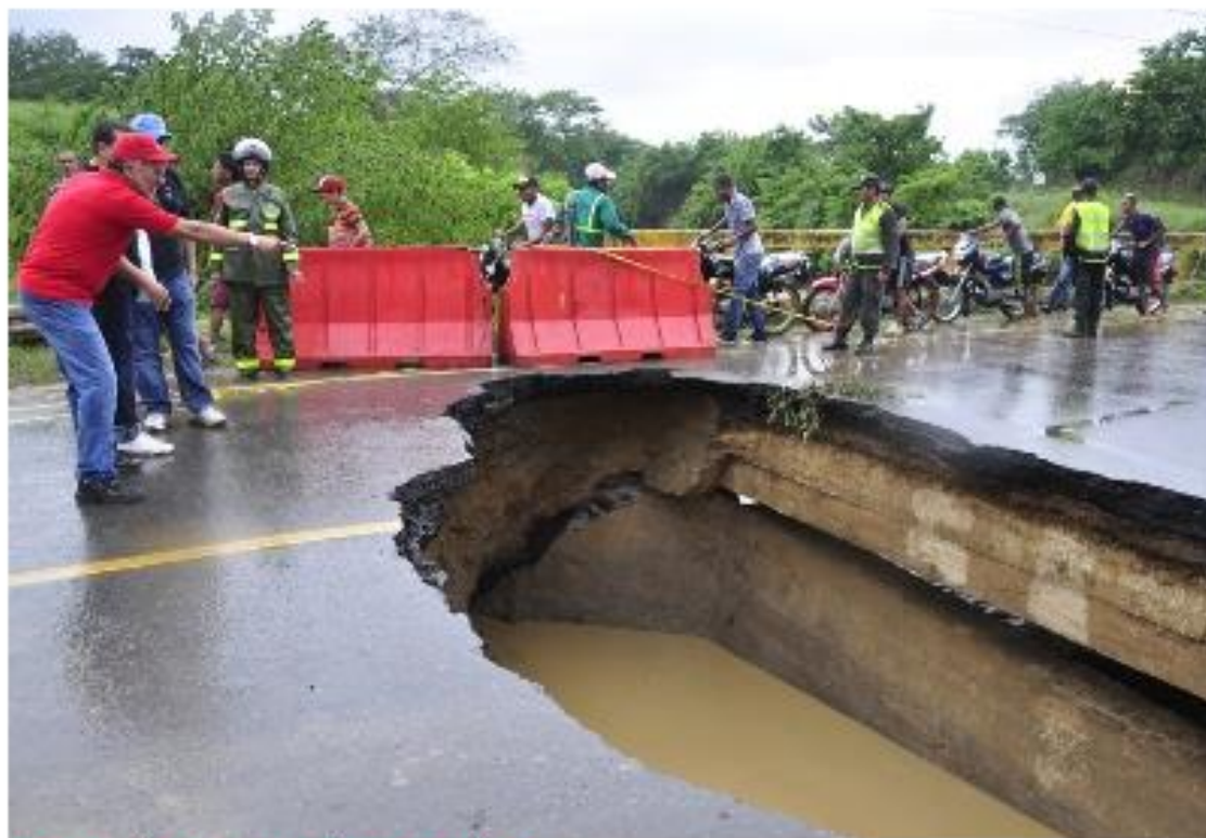
Cortesía. Gobernación del Atlántico. Daños registrados en la vía La Cordialidad, en el departamento del Atlántico.
